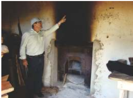
Secador com vazamento de fumaça
